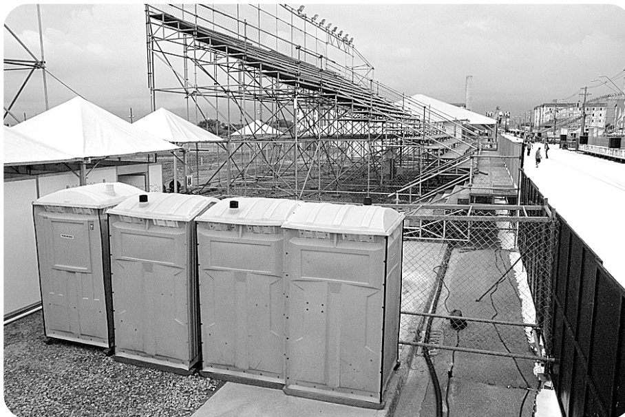
Para atender melhor o público, prefeitura instala 112 sanitários químicos no sambódromo
