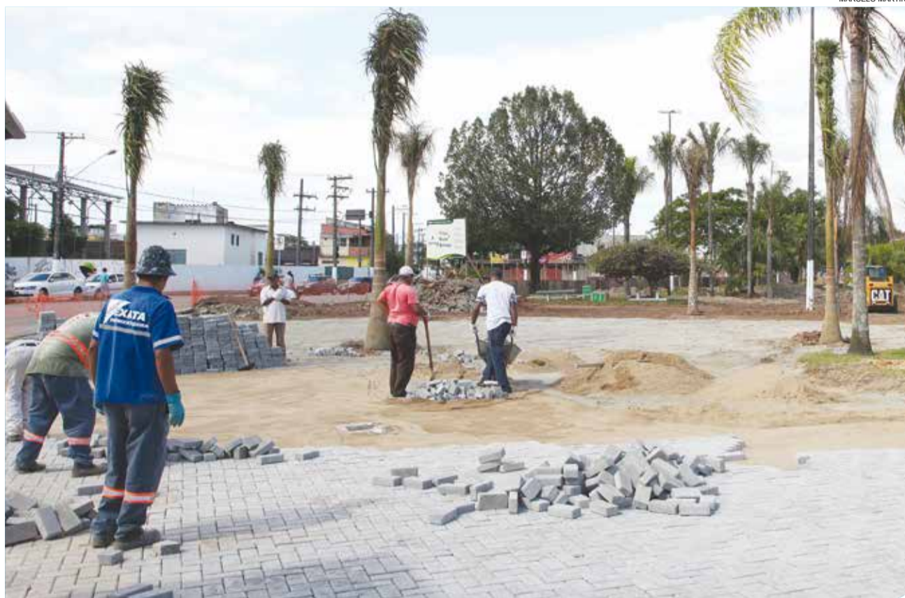
Equipes trabalham na preparação e colocação de novos pisos e implantação da mureta do playground
