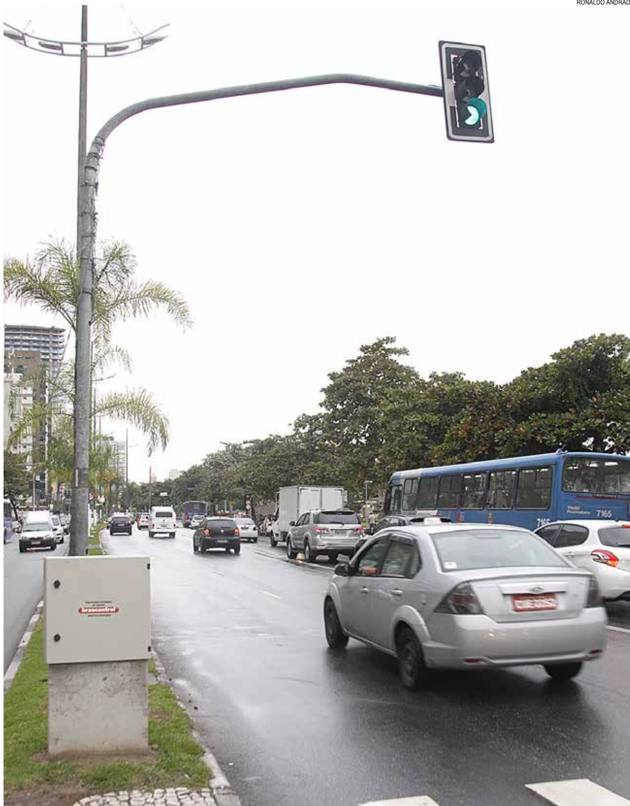
Aparelhos para controlar o tráfego (na imagem à esq.) já foram instalados nos semáforos da orla
