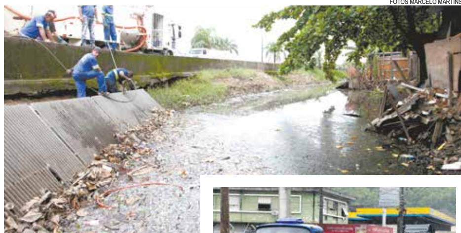
Detritos obstruem as galerias pluviais...
