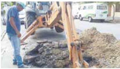
Abatimento na Rua Nove de Julho, no Marapé
