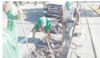
Abatimento na Av. Afonso Pena em frente a Praça Aparecida - Aparecida
