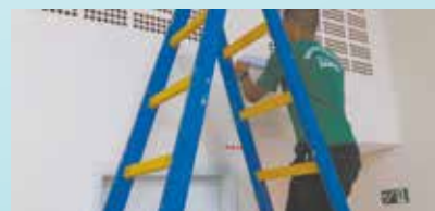
Instalação de lâmpadas de emergência na sociedade de melhoramentos da Nova Cintra
