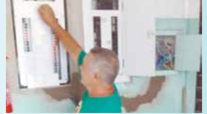
Instalação do quadro de energia do novo espaço da Vila Criativa - Caruara
