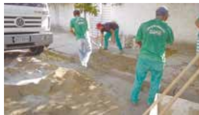
Reparo em calçada danificada por raízes de árvores na Rua Jurubatuba - Ponta da Praia
