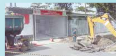
Ligação de esgoto no Samu do São Manoel
