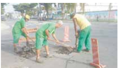
Reparo no abatimento das avenidas Cons. João Alfredo com Rodrigues Alves - Macuco
