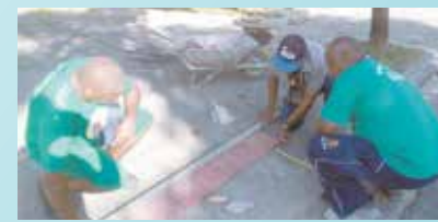
Assentamento do piso podotátil nas rampas de acessibilidade da Praça dos Ex-Combatentes - Rádio Clube
