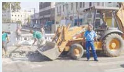
Reparação para nova calçada em concreto despenhado. Canal da Campos Sales - Vila Nova
