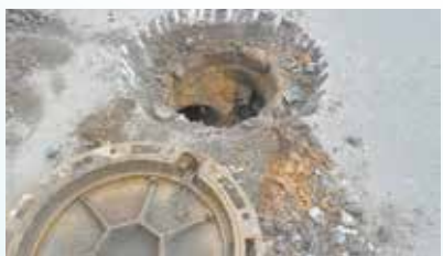
Troca de tampa de poço de visita na Rua General Câmara x Rua Martim Afonso - Centro
