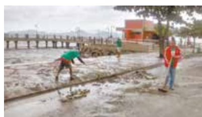
Limpeza dos destroços causados pela ressaca - Ponta da Praia
