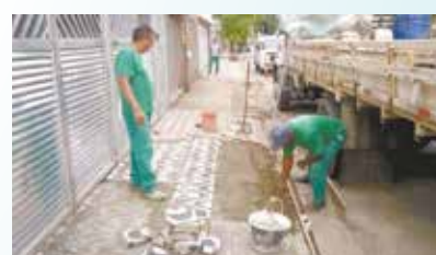
Reparo em calçada danificada por raízes de árvores na Rua Bezerra de Menezes - Estuário
