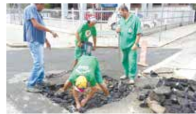
Reparo em abatimento na Rua Floriano Peixoto com Rua Olavo Bilac - Gonzaga
