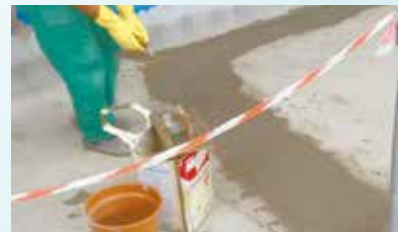
Fechamento do serviço de troca de tubulação de incêndio do Arena Santos - Vila Mathias
