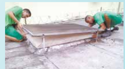
Vedação de lage no centro de triagem na Rua Joaquim Távora - Vila Mathias
