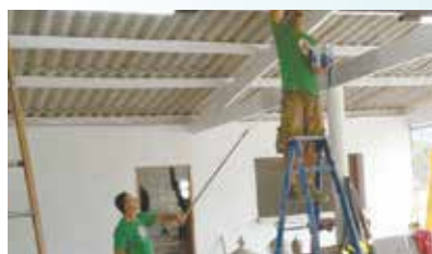
Concretagem da mureta, pintura e revestimento de cerâmica na Sociedade Esportiva de Caruara.
