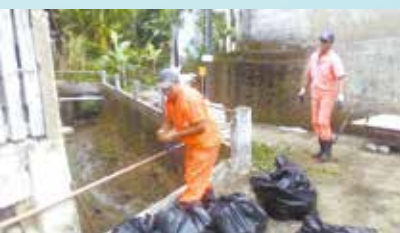
Limpeza de drenagem na Rua F- Morro José Menino (Equipe da Prodesan)
