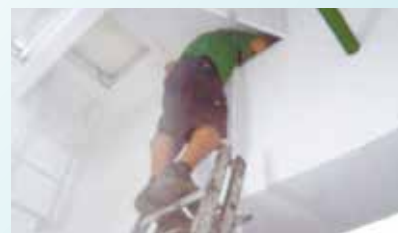
Manutenção de caixa de água na UME Avelino da Paz Vieira - Vila Nova
