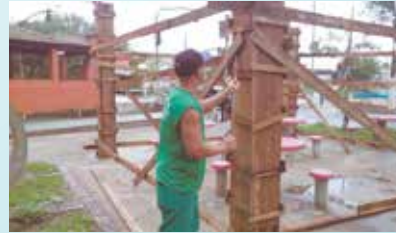
Desmontagem de formas dos pilares do quiosque na Praça Otávio Ribeiro - Vila São Jorge
