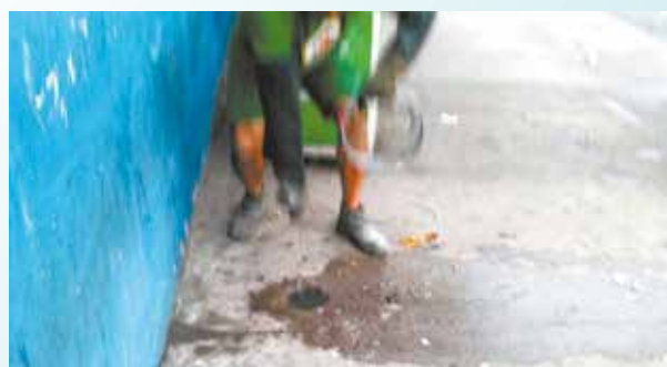
Desobstrução da rede de esgoto na UME Avelino da Paz Vieira - Vila Nova
