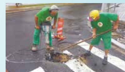
Reparo em Abatimento na Av. Siqueira Campos x Rua Germano Melchert - Embaré
