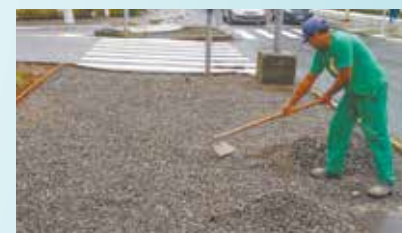
Preparação da calçada para receber o piso em concreto na Praça Gomide Ribeiro - Embaré
