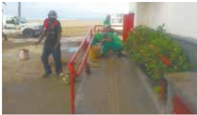
Manutenção do posto 4 - Gonzaga
