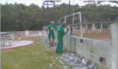
Continuação da demolição das paredes do campo da Praça Euzébio Rocha - São Manoel
