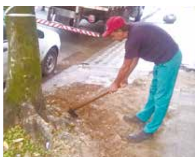
Calçada danificada por raízes de árvores na Rua Paraíba - Pompeia
