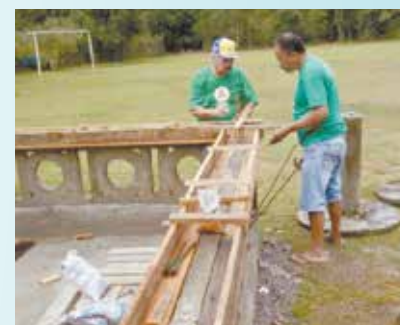
Continuação do madeiramento, concerto do reboco da mureta na Soc. Esp. de Caruara
