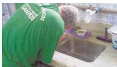
Colocação de cuba da pia e troca de sifão na República Renascer - Vila Mathias
