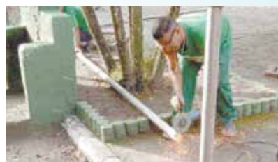
Solda das ferragens para posterior instalação de tela de alambrado na Pça. Monte Cabrão
