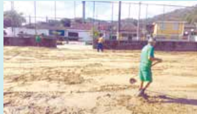
Nivelamento de areia no campo da Praça Guilherme Delius - Chico de Paula
