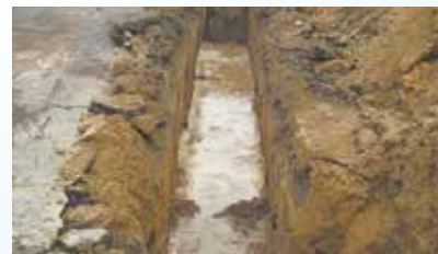
Continuação da recuperação da rede de drenagem auxiliar ao lado do Cemitério Paquetá
