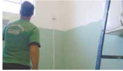
Lixamento de paredes e limpeza e capinação na futura sede da Vila Criativa - Caruara
