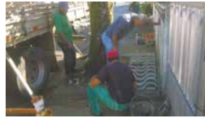
Manutenção de calçadas danificadas por raízes de árvores na Rua Pedro Arbues - Ponta da Praia
