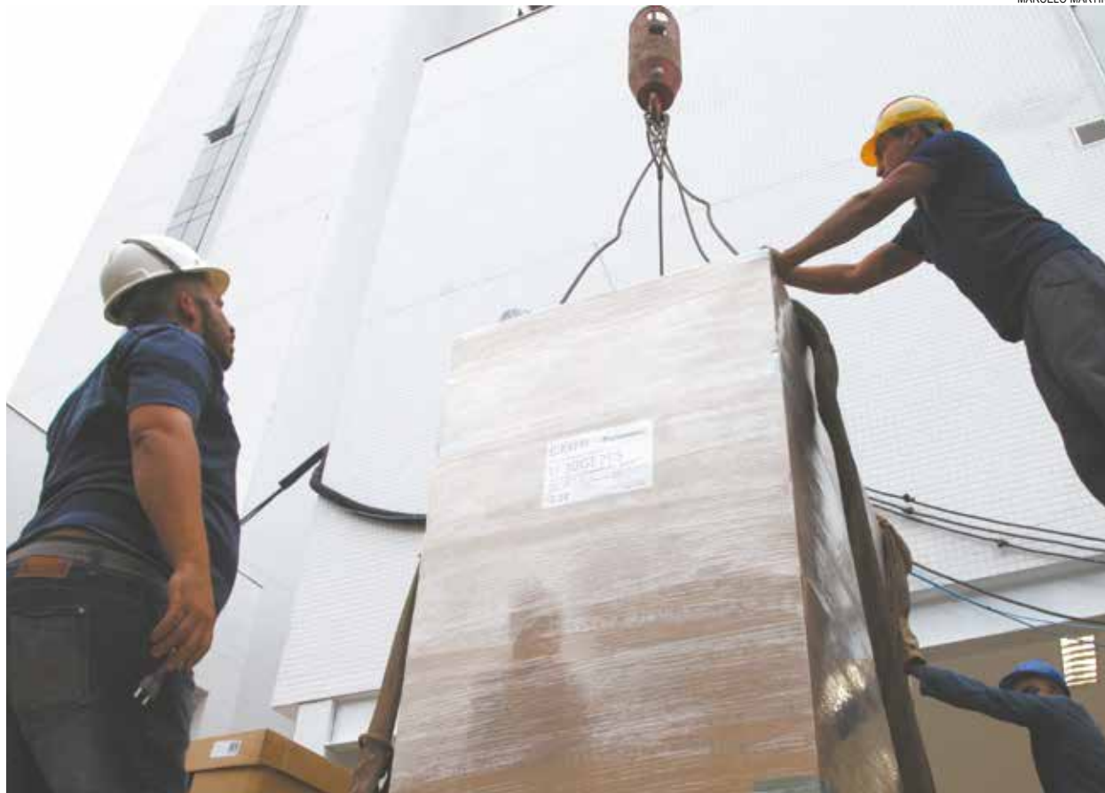
Nove máquinas pesando 800 kg cada foram içadas em operação especial e colocadas na cobertura do bloco B
