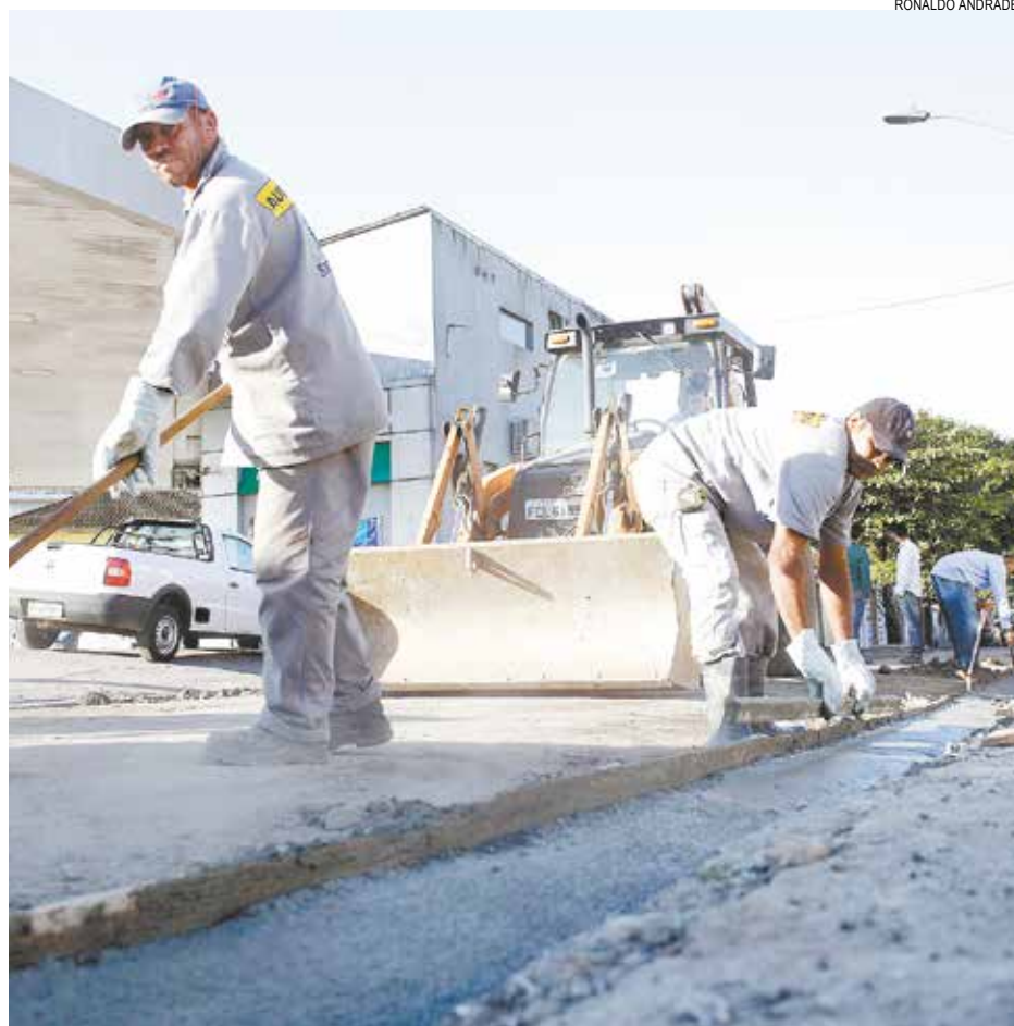
Além da renovação do pavimento, obra contempla serviços em guias e sarjetas
