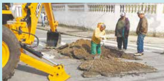
Tapa buraco na via pública e preparação piso asfáltico na Rua Torquato Dias - Nova Cintra
