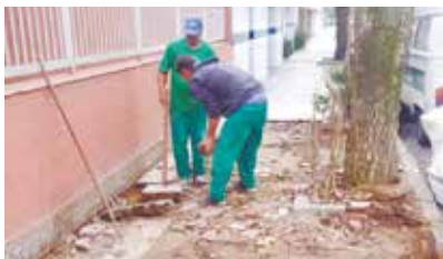
Reparo em calçada danificada por raízes de árvores na Rua Carvalho de Mendonça
