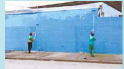
Término da pintura do muro externo da UME Oswaldo Justo - Chico de Paula
