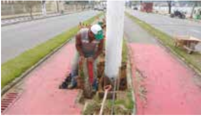
Abatimento na ciclovia em frente ao deck dos pescadores - Ponta da Praia
