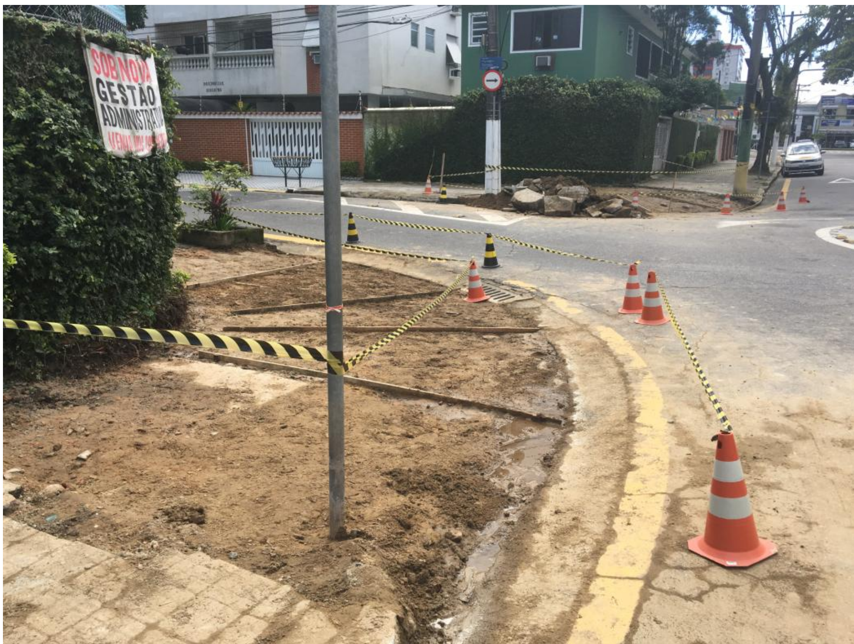
Sinalização utilizada, insuficiente em relação ao requisitado em contrato
