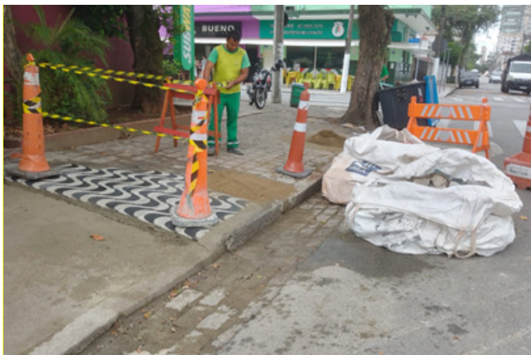
Reparo em calçada danificada por árvore, na Rua Visconde de Cairu
