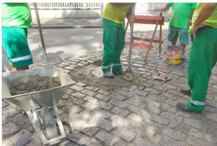
Concretagem em torno de Poço de Visita na avenida Barão de Penedo
