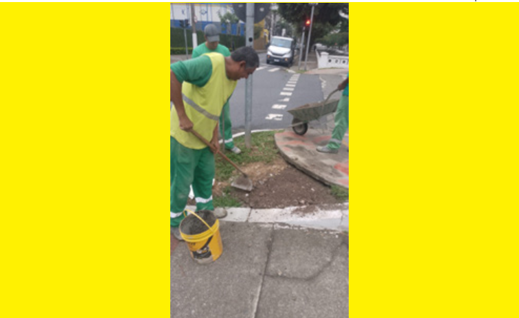
Abatimento na esquinas da Av. Almirante Cochrane com a Rua João Mendes
