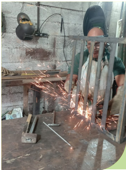
Produção de três grades de ar-condicionado que serão instaladas na Policlínica do Rádio Clube
