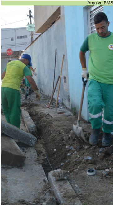
Drenagem na Rua Vigilato Hernani A. Franco Baccarat, na Areia Branca
