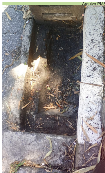
Serviço de limpeza de grelhas na Rua São Roque, no São Bento
