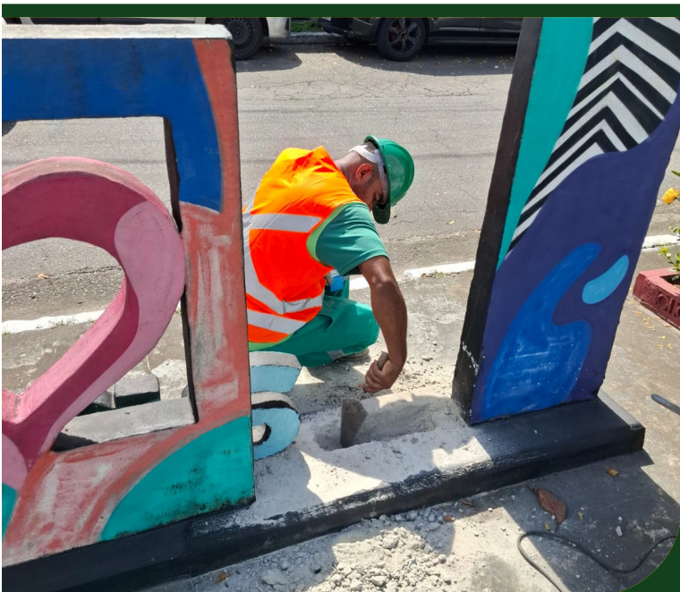
Substituição de letras vandalizadas e construção de mureta de proteção no totem da Praça João de Moraes Chaves
