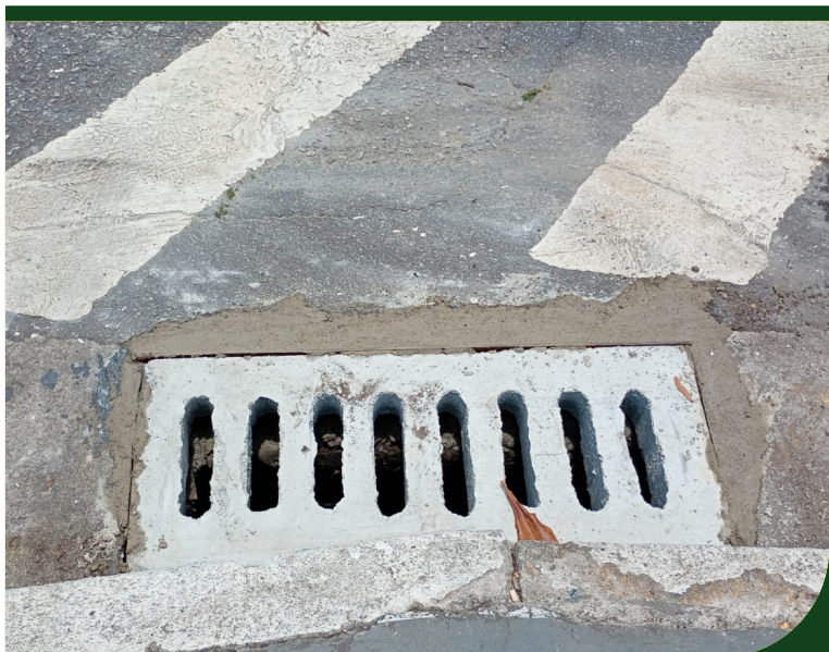
Substituição de boca de lobo na esquina da Rua Pérsio de Queiroz Filho com Guedes Coelho
