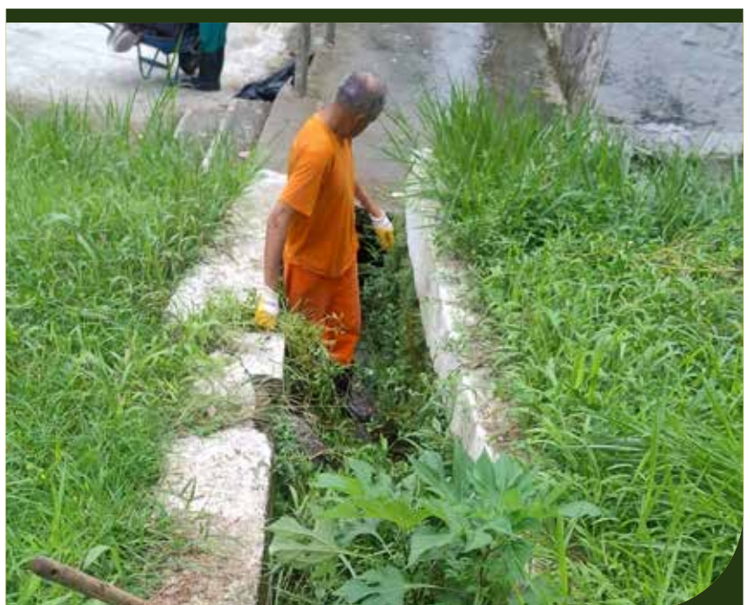
Limpeza de grelhas, canaletas, caixa e escada hidráulica na Rua Rubião Júnior, no Morro Fontana
