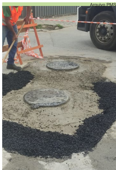
Rebaixamento de laje e substituição de dois poços de visita no Chico de Paula
