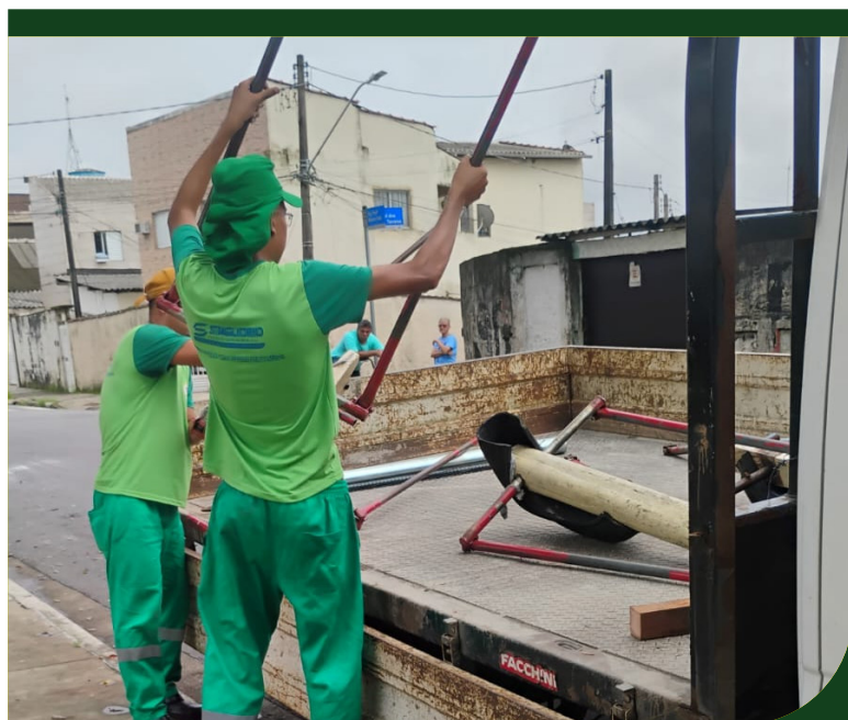
Remoção de brinquedos quebrados do playground da Praça Prof. Nicanor Ortiz, na Areia Branca
