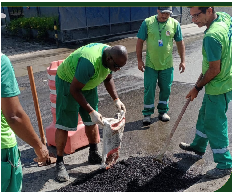
Conserto em tampa de concreto na Avenida Nossa Senhora de Fátima, em frente ao número 120, na Areia Branca
