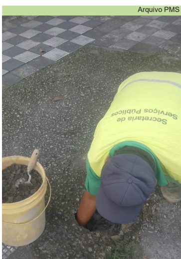
Reparo na calçada: Senador Feijó com a Guedes Coelho, na Encruzilhada
