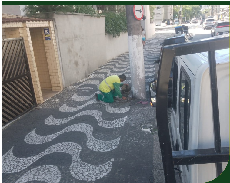
Reparo no piso mosaico na Avenida Epitácio Pessoa, em frente ao número 303, no Embaré
