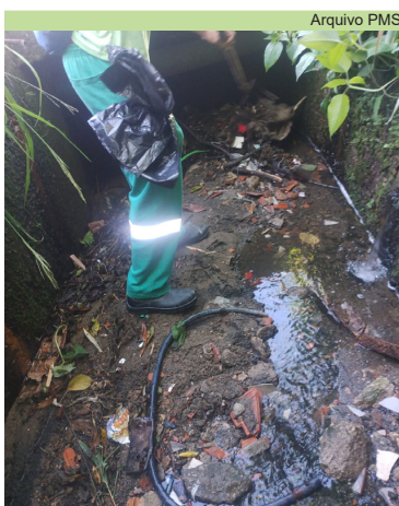
Limpeza de caixas e do canal na Avenida Brasil, no Morro Nova Cintra
