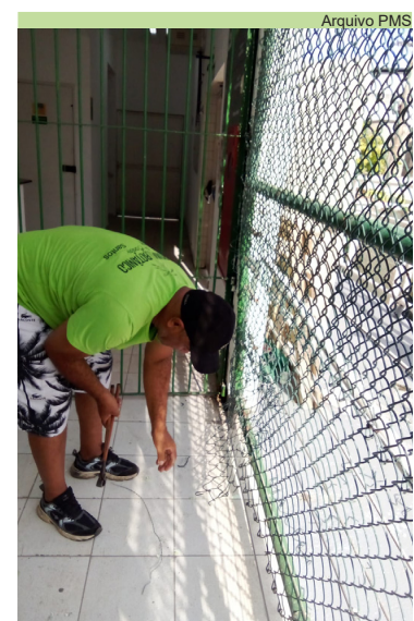
Reparos no alambrado do bloco B cultural no Sambódromo, na Av. Afonso Schmidt
