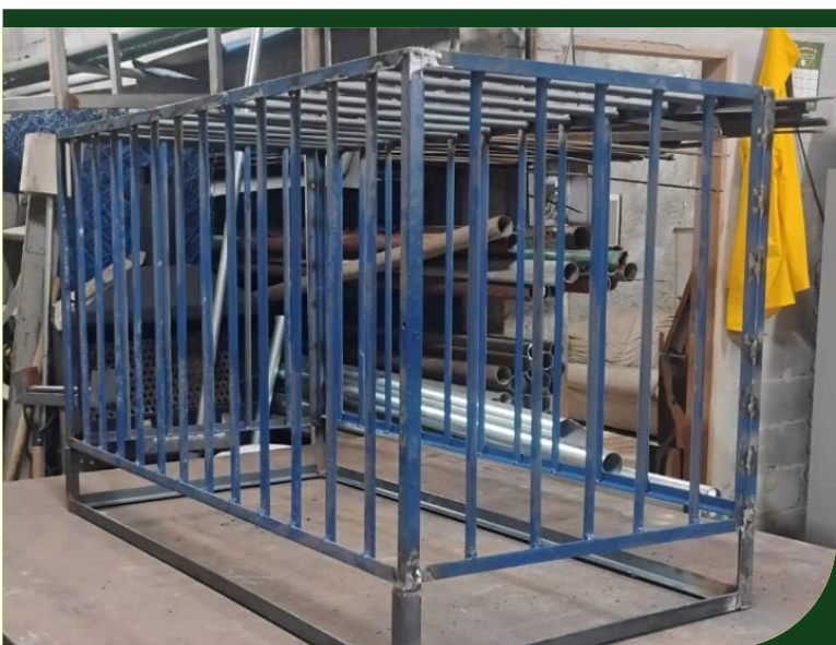
Produção de grade de proteção para o aparelho de ar-condicionado da unidade Posto Avançado de Zeladoria
