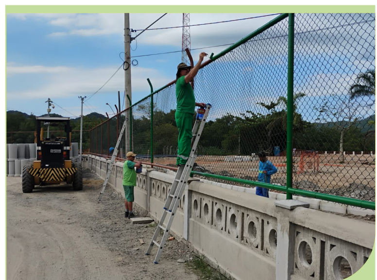
Pintura dos tubos do alambrado na mureta da Coordenadoria Técnica, no Caruara
