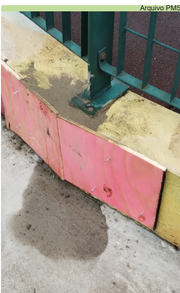
Chumbamento de gradil na Praça Cândido Portinari, no Marapé
