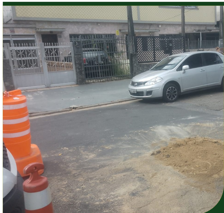
Manutenção asfáltica na Rua Maria Máximo, em frente ao número 103, na Ponta da Praia
