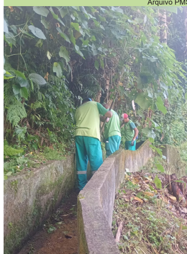
Limpeza de caixas e escada hidráulica na Rua São Cristóvão, no Morro São Bento
