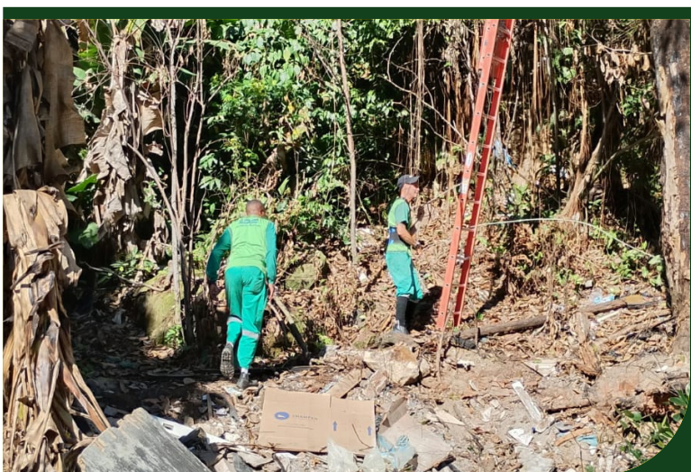
Corte de árvore, com risco de queda, na Rua Manoel Garcia Vilarinho, em frente ao número 556, no Nova Cintra
