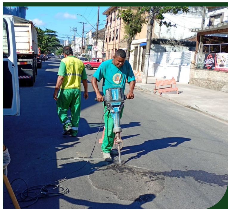
Manutenção asfáltica na Rua José do Patrocínio, em frente ao número 36, no Macuco
