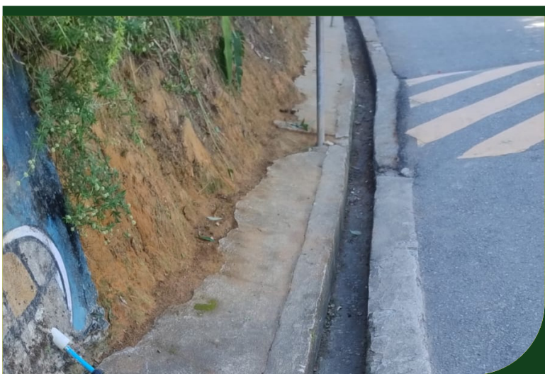
Limpeza de canaleta na Rua Carlos Alberto Curado, no Morro José Menino
