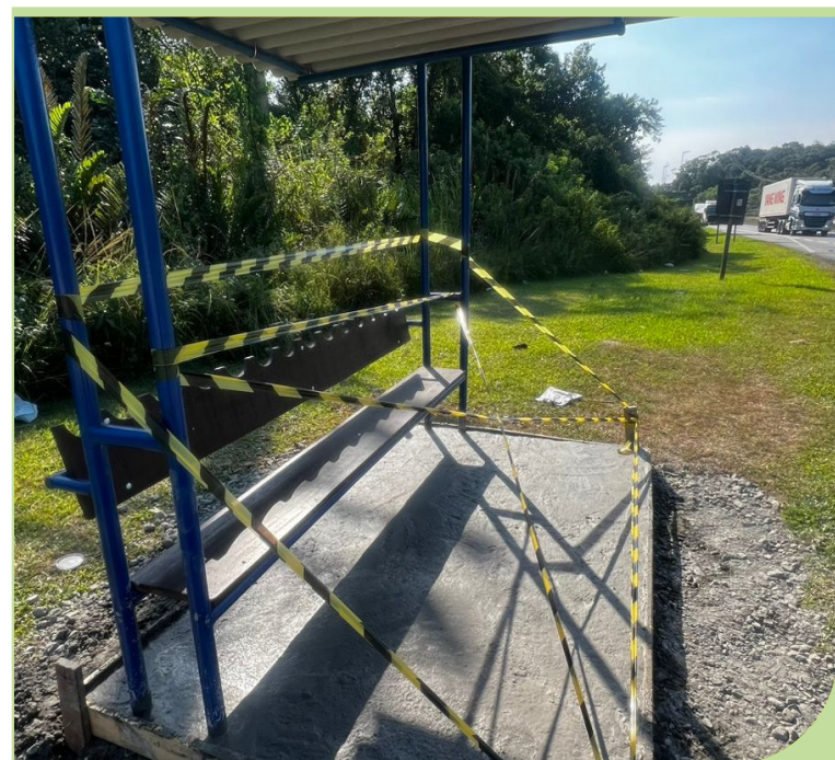
Concretagem da base do ponto de ônibus no Monte Cabrão, sentido Guarujá
